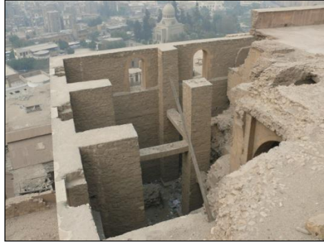
( لوحة رقم ١٣ ) الركن الجنوبي للسبع قاعات بعد الترميم يطل على الميدان أسفل القلعة
